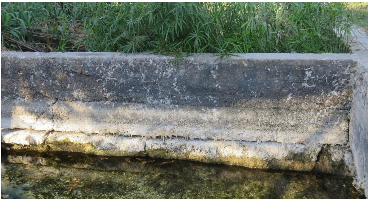
Figura 4 - Muro in cls con segni delle piene
