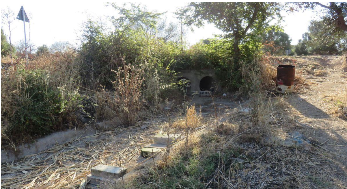
Figura 10 - n.2 tubi sottopasso di scolo
